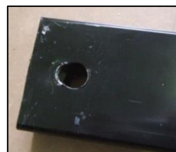
図 3 斜材端部の降伏性状
