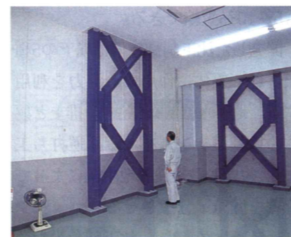
1階に取り付けられたGVA-WSDのユニット (写真: 本誌)
