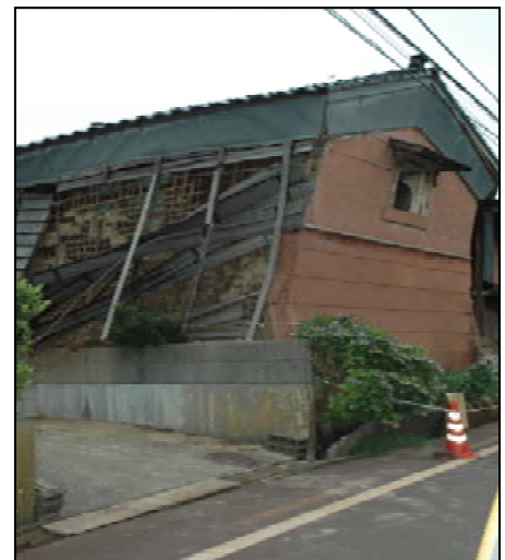
古い土蔵の被害
