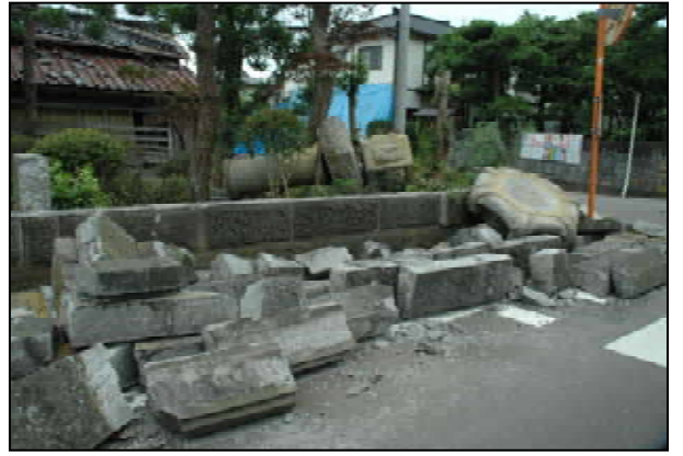
大谷石堀の被害
